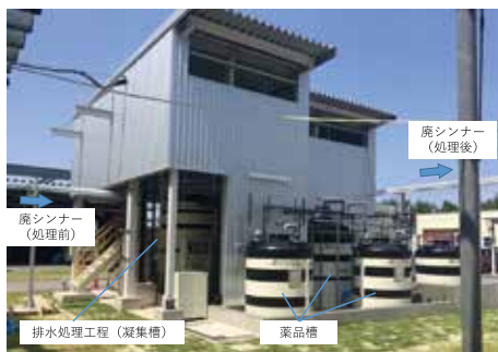
<処理設備の外観>
