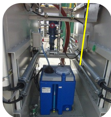
安定(凝結遅延)剤添加装置
