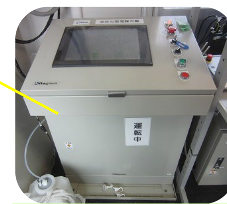
スラッジ水高度利用安定化管理制御盤
