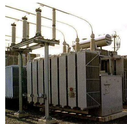
大型変圧器(地上設置)
