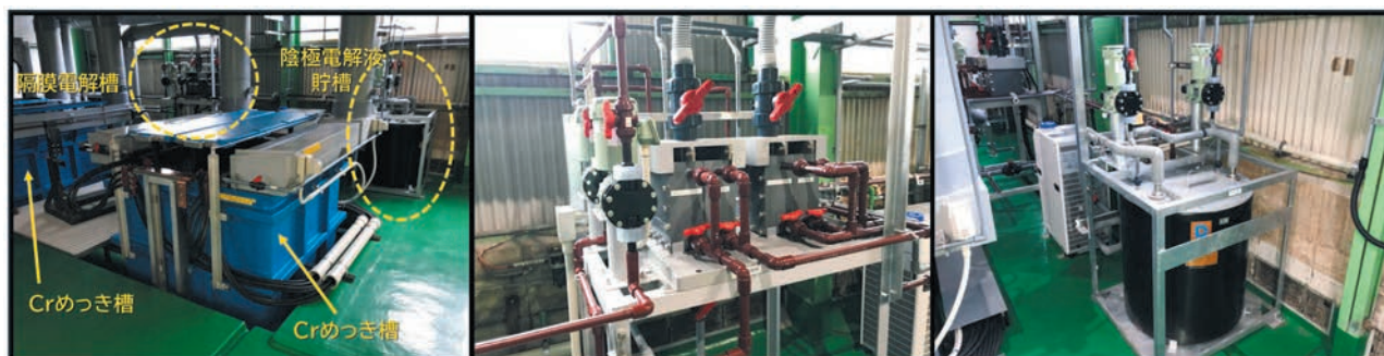
クロムめっき槽(3m³)2基と再生装置
