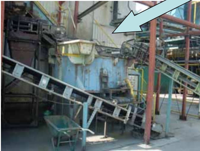
・ロックウール綿粉碎設備
