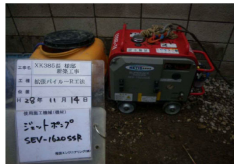
2.高圧洗浄機、タンク
